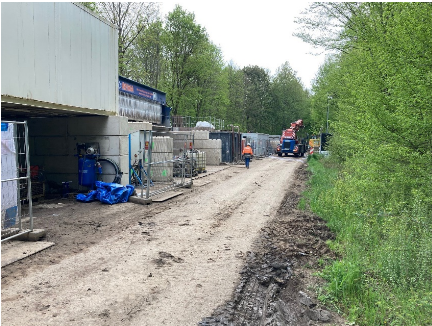
Anlagentechnik auf dem Wanderparkplatz
